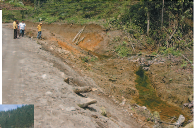
Cuerpo de agua inadecuadamente desviado dentro de las plantaciones de Río Pizará.
