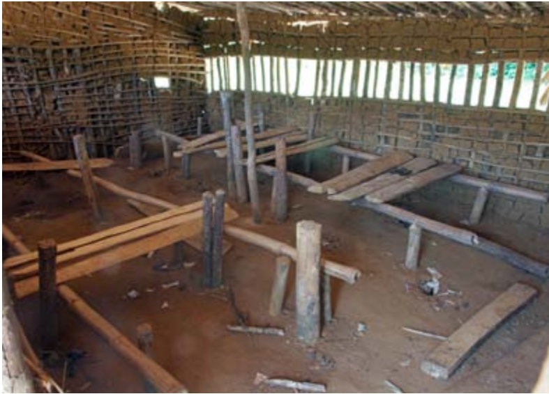
Foto 2. Una escuela primaria en ruinas, en una zona donde opera Feronia. (Foto: Oskar Epelde)
