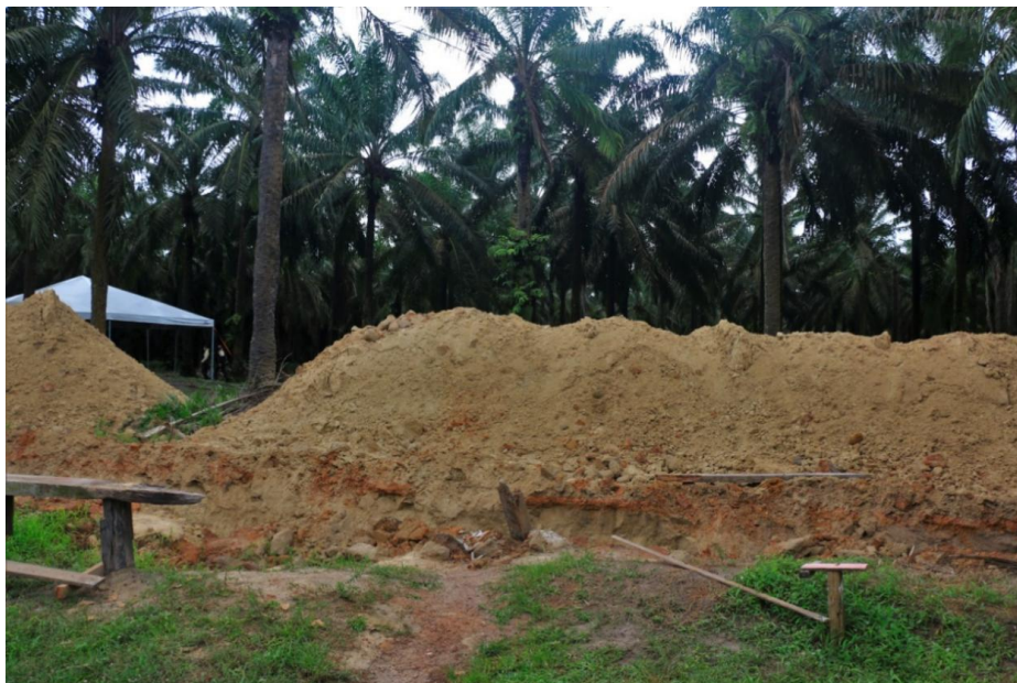
Figura 22 - Barreira de barro e vala aberta na vila Palmares
