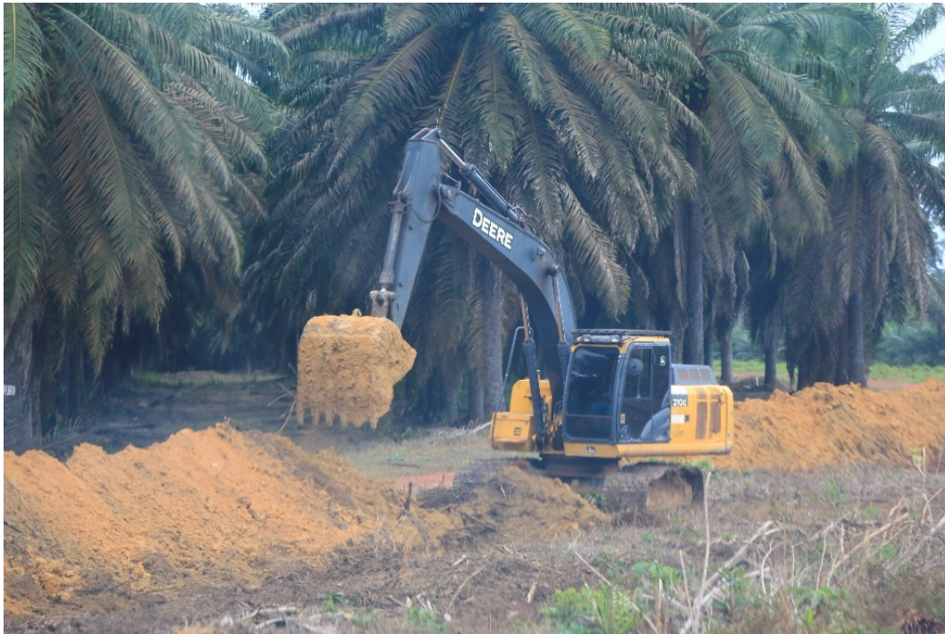
Figura 19 - Retroescavadeira utilizada na abertura de trincheiras (valas), às proximidades da Vila Palmares
