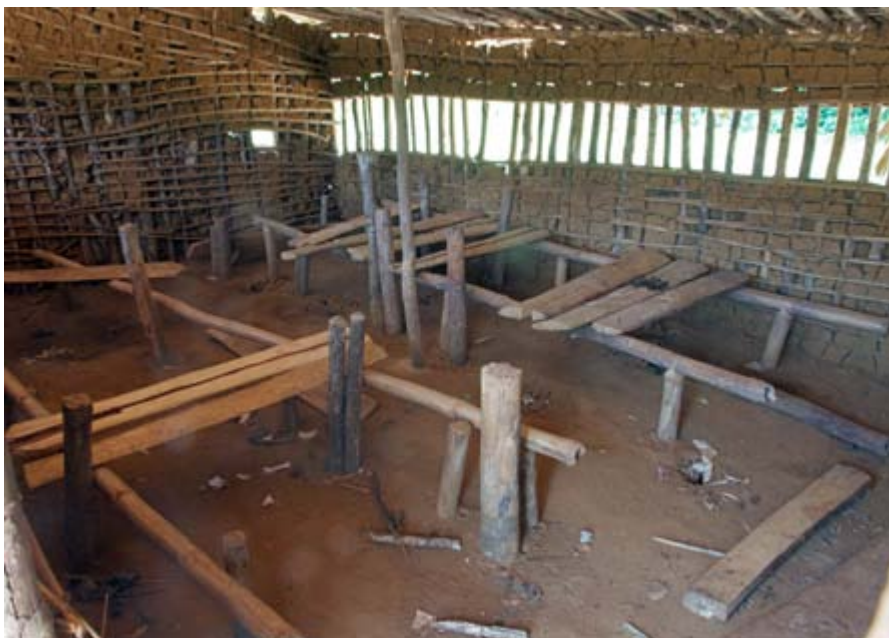
Une école primaire délabrée dans un zone d'opérations Feronia. (Photo : Oskar Epelde)
