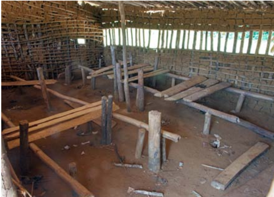
Une école primaire délabrée dans une zone d'opérations Feronia. (Photo : Oskar Epelde)
